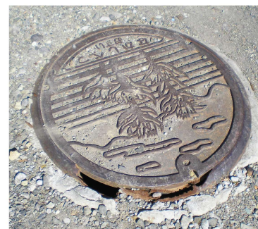
破損したマンホール
