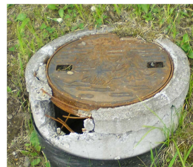
破損した公共ます
