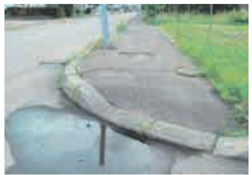
わずか4cm程の段差で車椅子が登れない歩道
