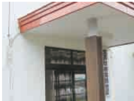
老朽化が進む地域会館
