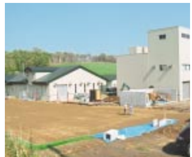
水処理・破砕施設
