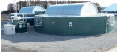
バイオガスプラント
