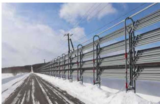
↑ 防雪柵 (吹き流し柵) ぼうせつさく ふ なが さく
