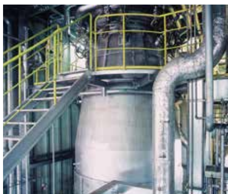
↑ガス冷却室 排ガスを冷却します
