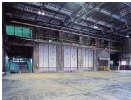
↑プラットホーム ごみを受け入れます
