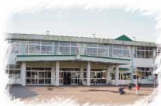
老朽化した現校舎
